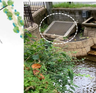
オーバーフロー枡(最下流部)
